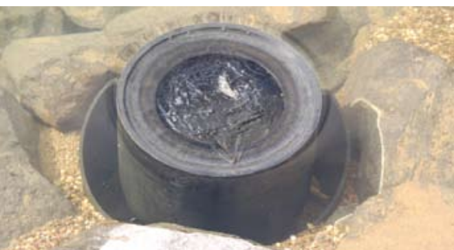
Rundskimmer sorgen für die Reinigung der Wasseroberfläche.
